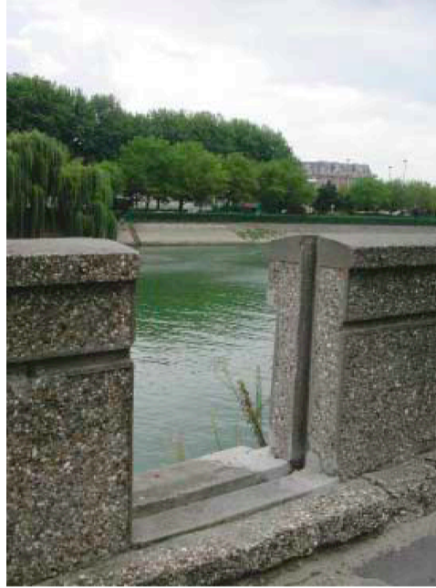
FIG. 1.1 : Murette anti-crue et emplacement du batardeau (Courbevoie)
