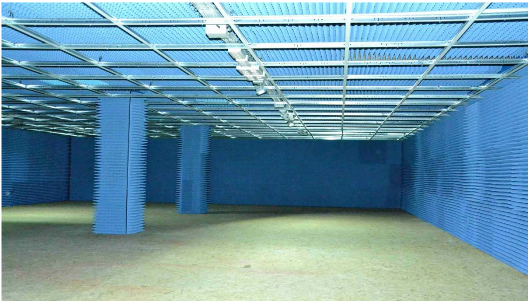
Figure 4. La salle d'expérimentation de la plateforme CorteXlab à l'INSA de Lyon.
