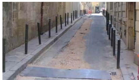
Figure 1: Exemple de trottoir étroit en France.
